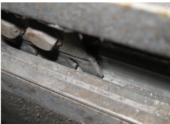
图8 门脚滑块脱落
