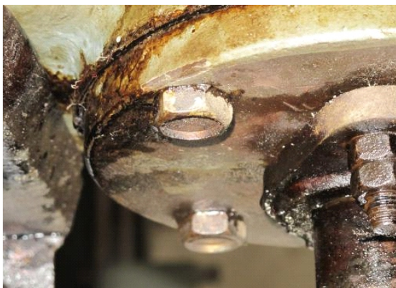
图7 曳引机组渗漏油严重
