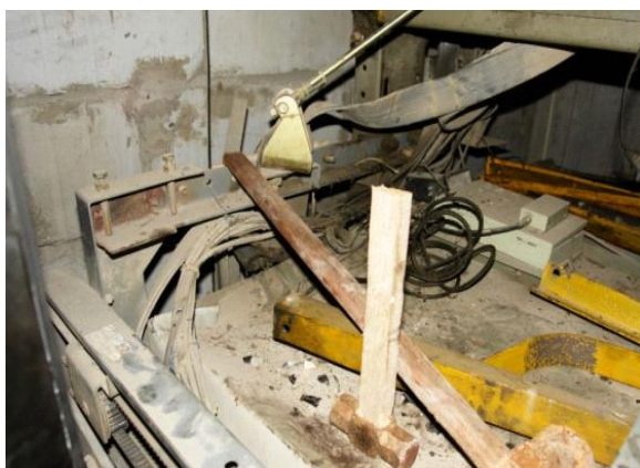
图21 冲顶后被撞击坏的轿顶
