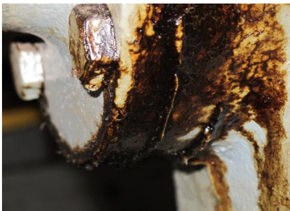
图6 曳引机组渗漏油严重
