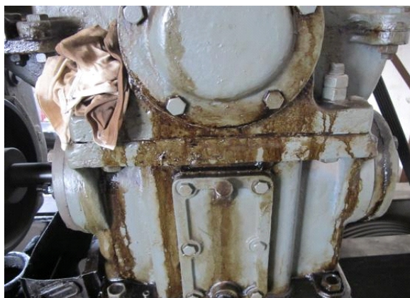
图5 曳引机组渗漏油严重
